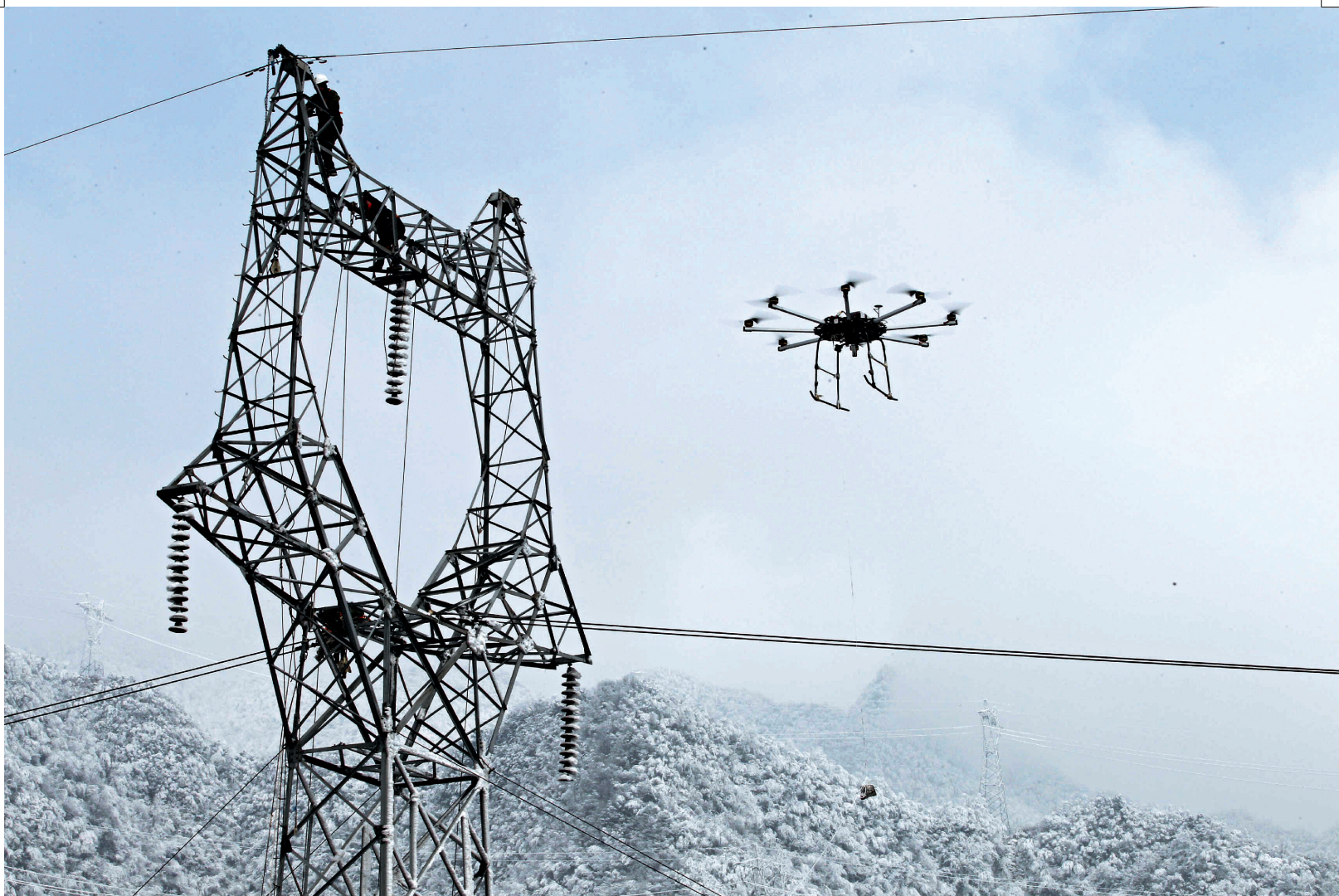
▲ 2月14日，在海拔1380米的湖北宜昌长阳县贺家坪镇，一架八旋翼无人机将携带的迪尼玛牵引绳准确投掷到因雨雪天气受损的220千伏麂泉线铁塔上。摄影/李季
