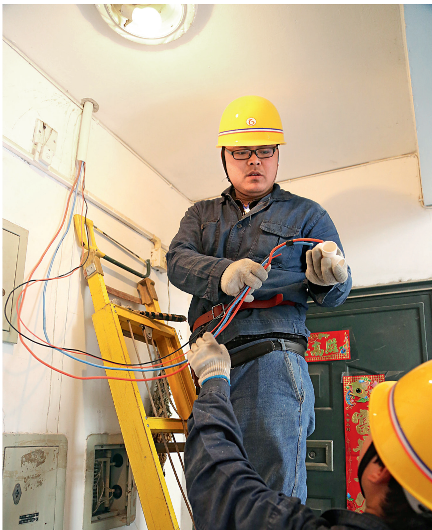
▲ 河南洛阳市供电公司高效沟通推动用户供电资产移交工作创新。
