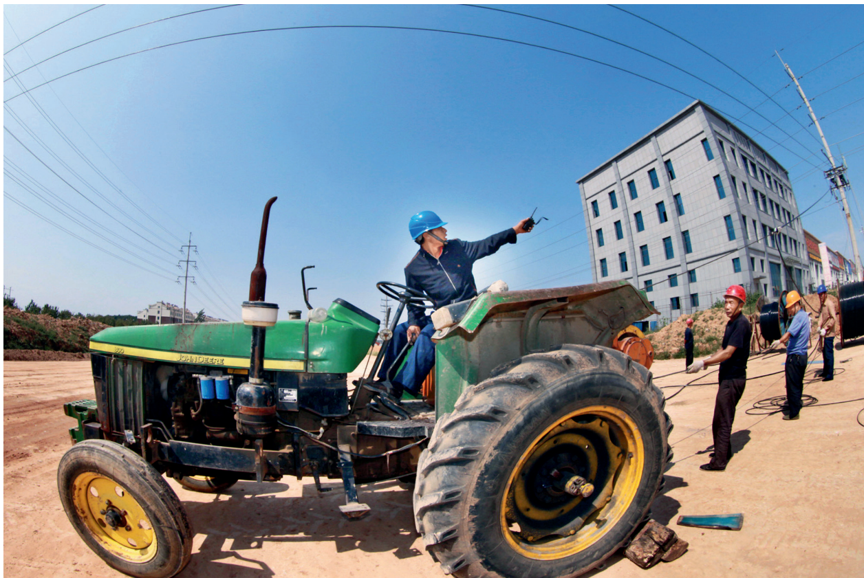
▲ 国网山东临朐县供电公司优化改造农网线路，助力经济发展。井玉霞 / 摄
