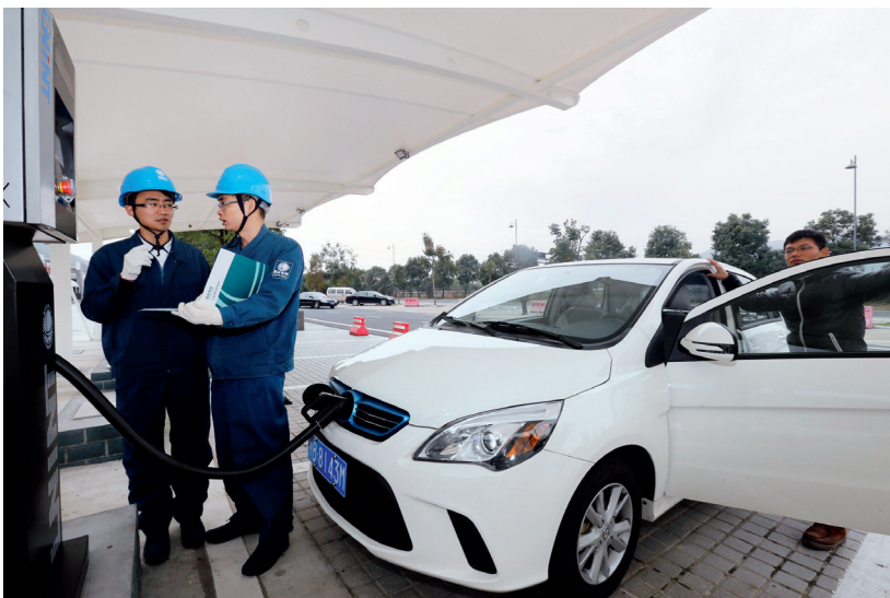
▲ 溪口供电所台区经理检查充电桩运行情况。摄影 / 吕峰
