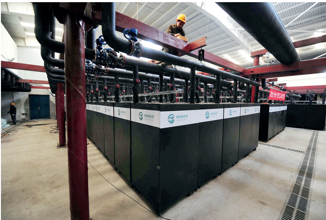
▲ 集中式变相储能锅炉利用谷电将电能转成热能，白天为居民供暖。
