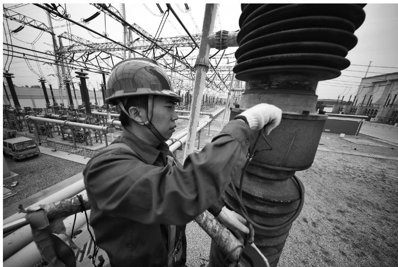
冯新岩在特高压变电站工作
