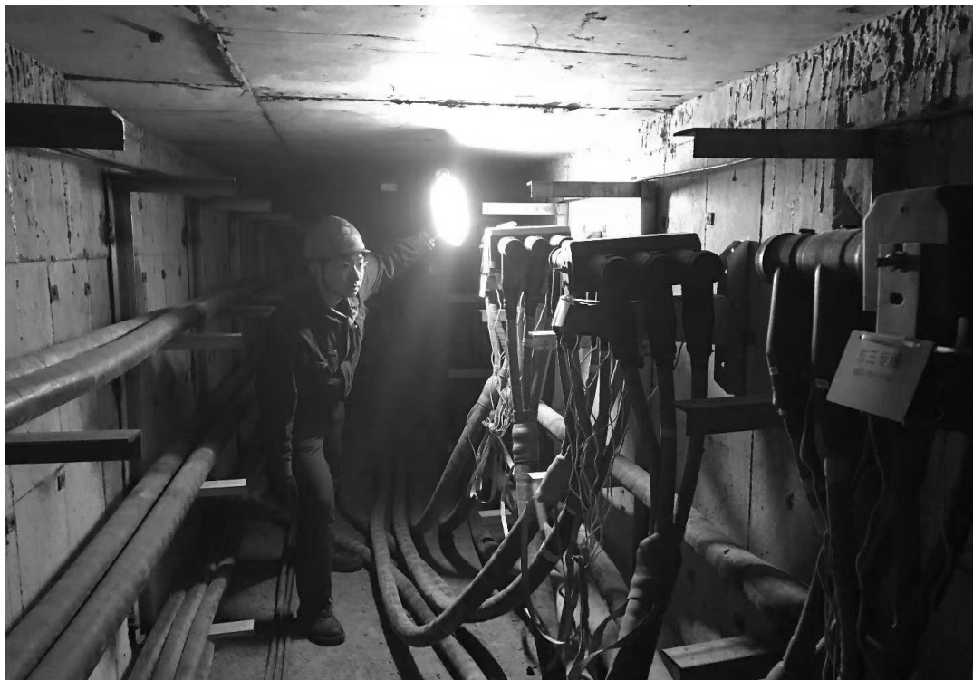
刘传波在电缆隧道巡检
