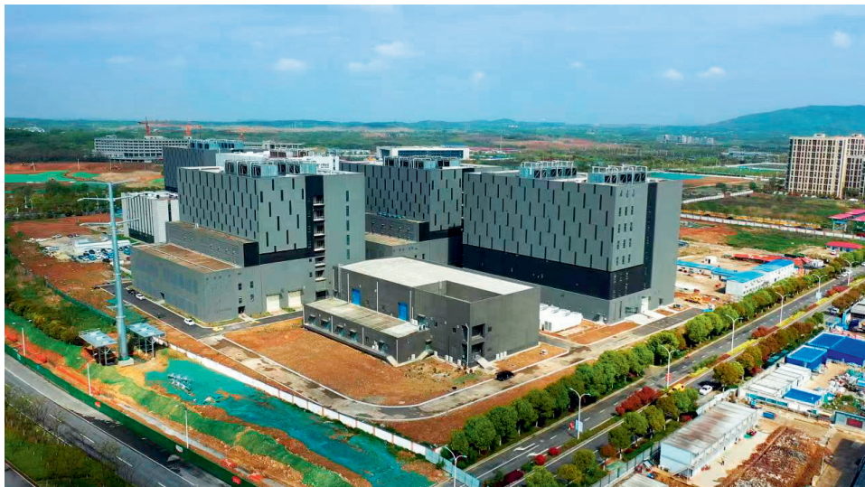
>> 2021年4月7日，江苏南京，南京苏逸实业有限公司工作人员正在中国电信股份有限公司江苏分公司吉山数据中心220千伏变电站工程现场，筹备协调设备调试等相关工作，变电站内电气设备已安装结束。
