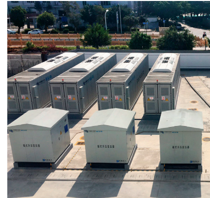
110千伏潭头变电站储能设施
