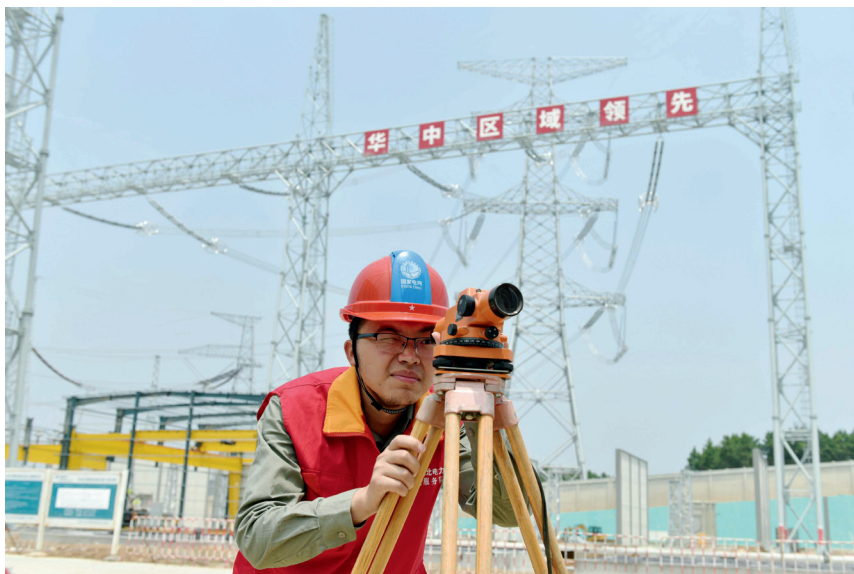
>> 国网湖北电力员工正在1000千伏武汉变电站为电气设备安装做准备。（上图 邹小民 / 摄） 宜昌秭归港，清洁电能通过岸电系统源源不断供给到游轮上。（右上图 李治飞 / 摄） 利川市齐岳山风电厂。（右下图 江汉 / 摄）
