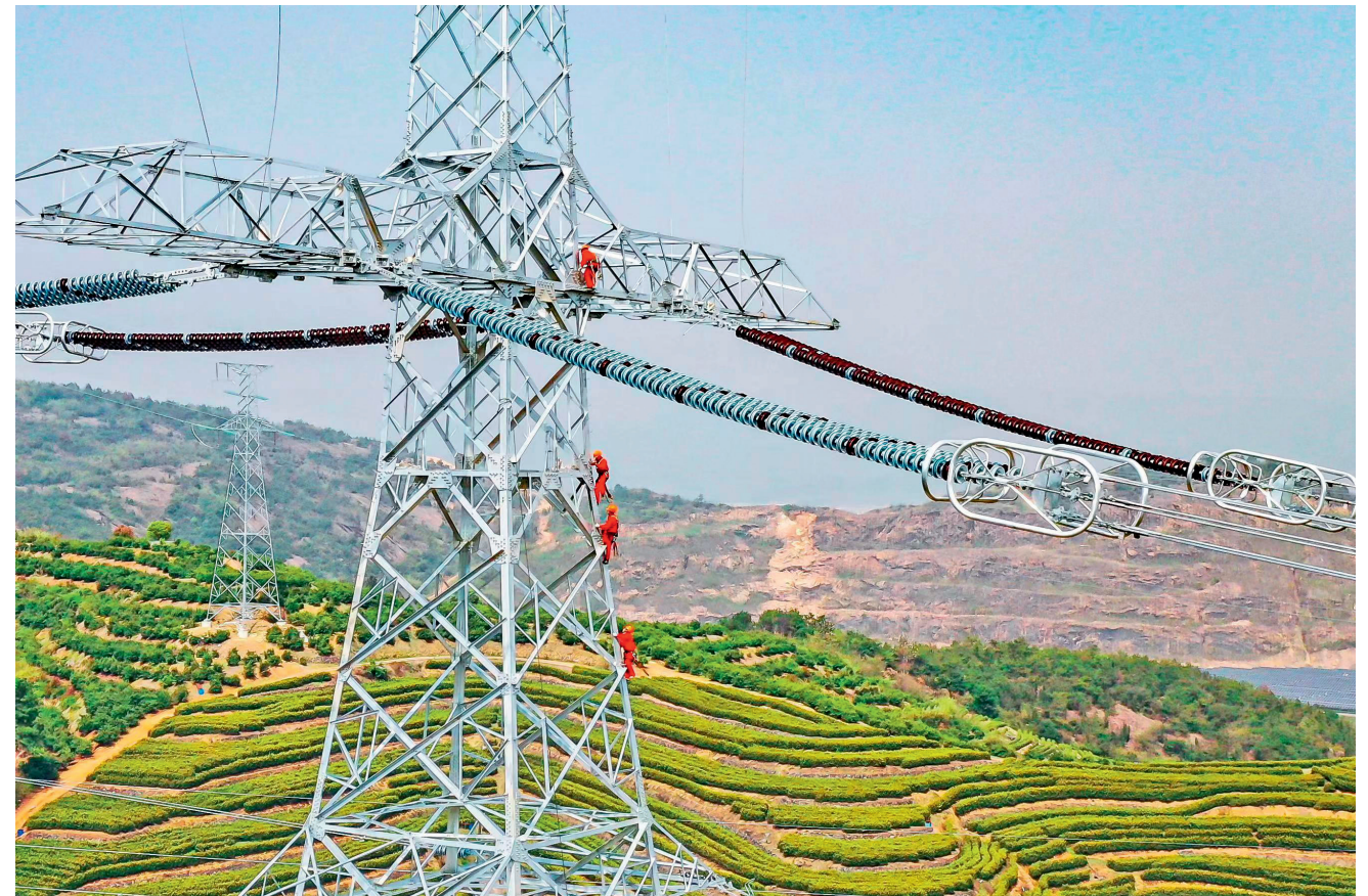
>> 国家电网员工在白鹤滩—浙江±800千伏特高压直流输电工程现场登塔作业。
